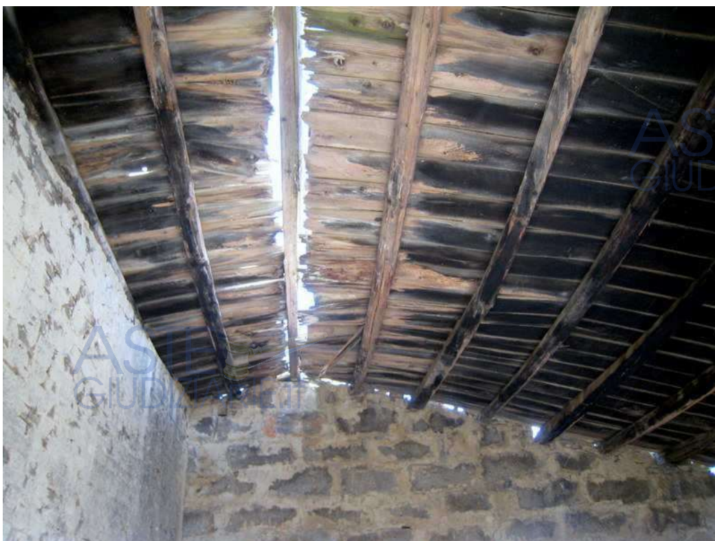
Foto n. 6. Le condizioni del tetto sono pessime.
