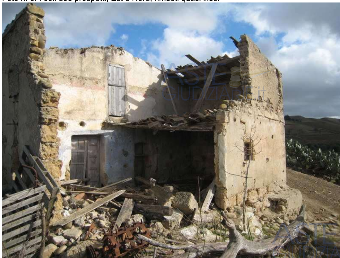
Foto n. 6. Il prospetto Sud e parzialmente quello est sono crollati. Il debitore ne è proprietario per la frazione di \frac{1}{2} indiviso.
