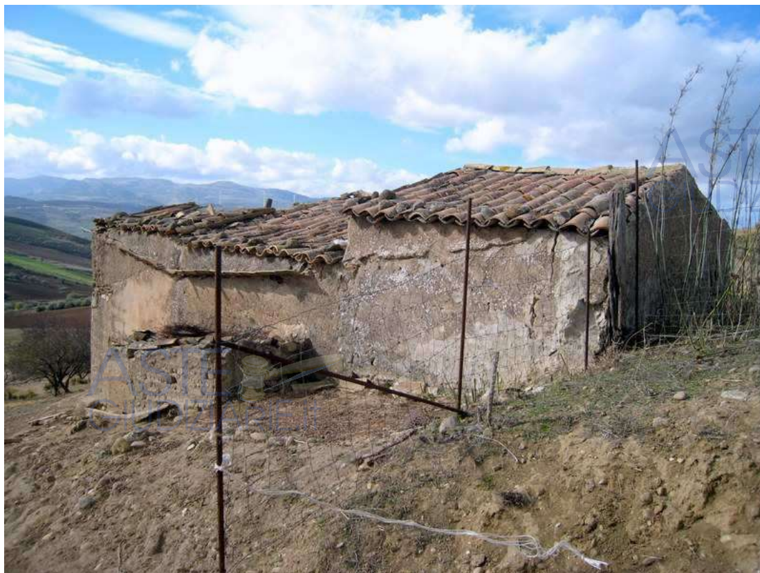
Foto n. 5. I soli due prospetti, Est e Nord, rimasti quasi illesi
