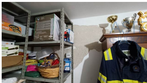
Umidità pareti e distacco della finitura
