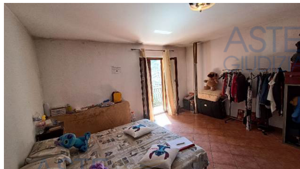
Muffe dovute a condensa superficiale
