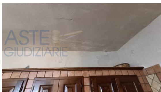
Umidità soffitto e pareti contro terra
