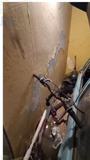
Ambiente 3 - Umidità di risalita
