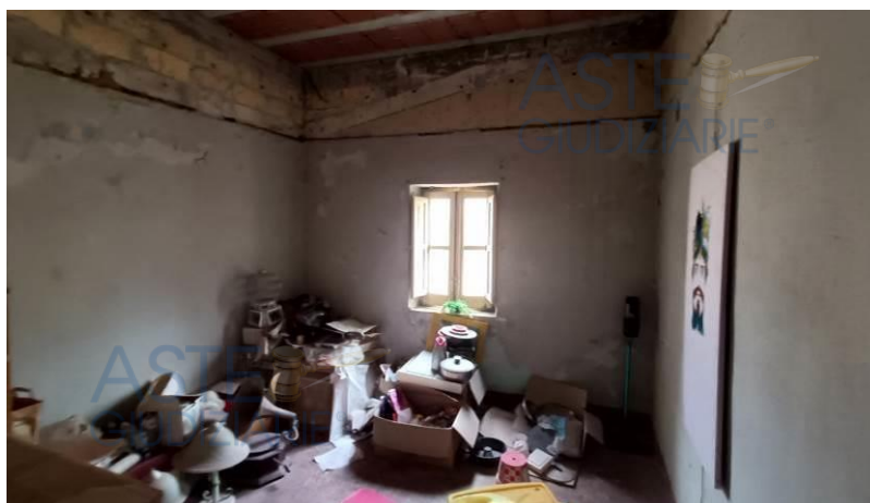
Piano 2 - Condizioni fatiscenti
