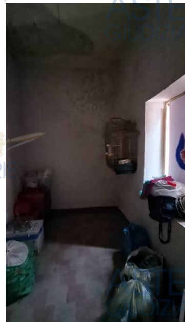
Piano 2 - Condizioni fatiscenti
