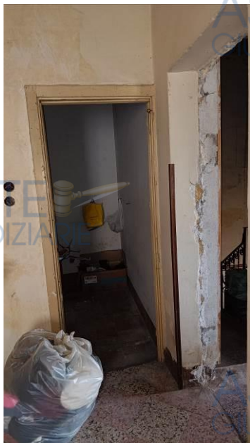
Piano 2 - Condizioni fatiscenti
