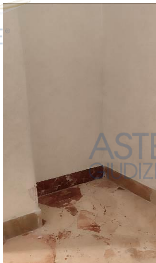
Soggiorno 4 - Umidità di risalita
