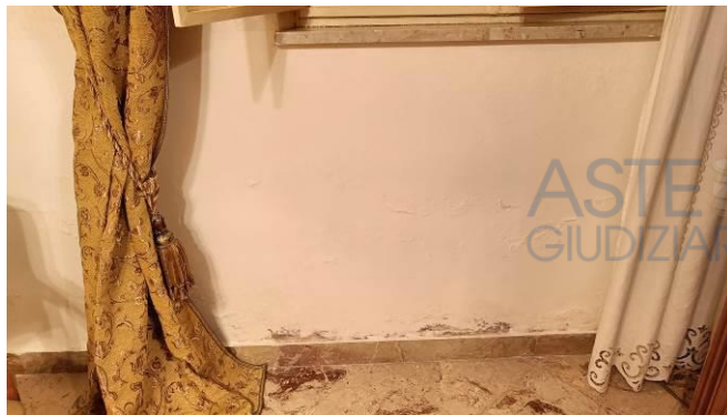
Camera 3 - Umidità di risalita
