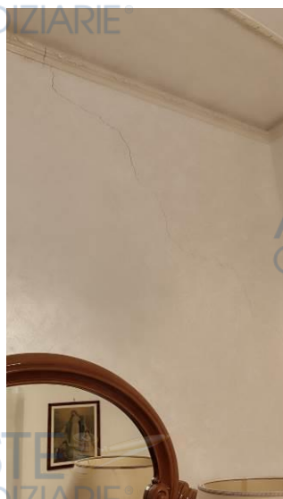
Lesione muratura lato camera 3
