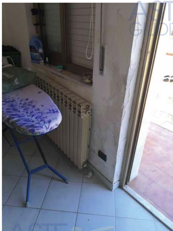
Foto n. 19 – umidità muro camera da letto
