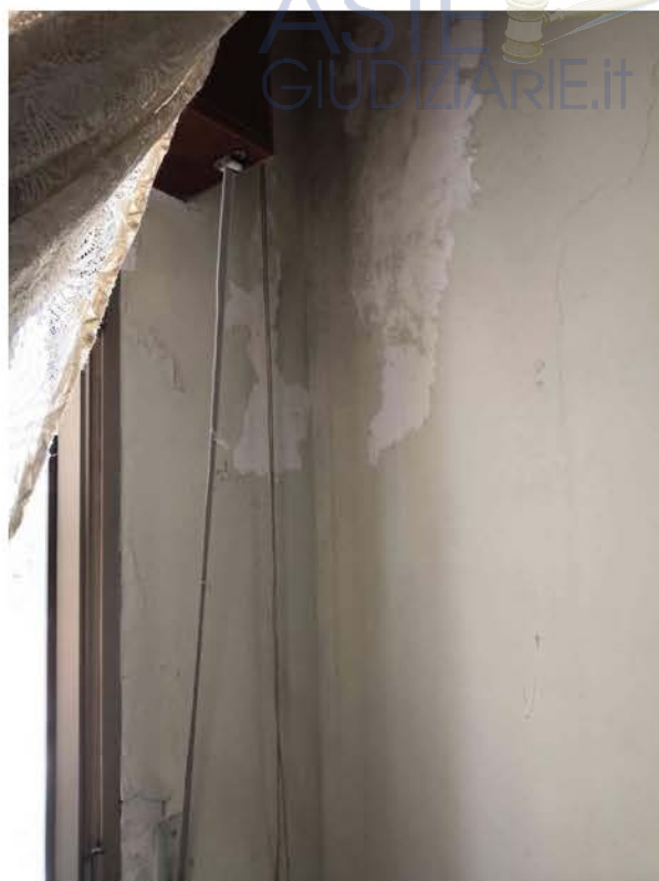
Foto n. 18 – umidità soffitto camera da letto
