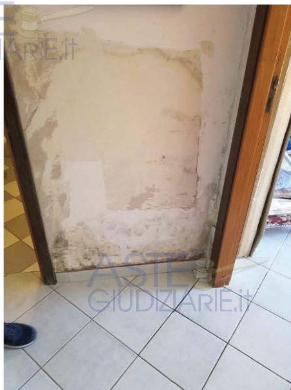
Foto n. 20 – umidità muro disimpegno
