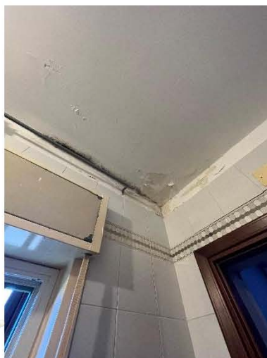
Foto 8- Sfogliatura del soffitto del wc
