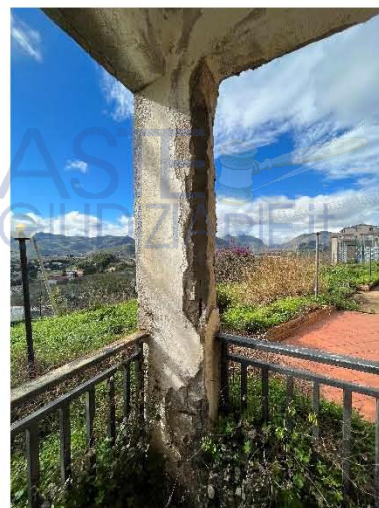
Foto 9- Ossidazione dei ferri di armatura
