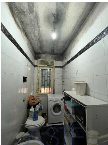
Foto 7- Muffa sul soffitto del wc
