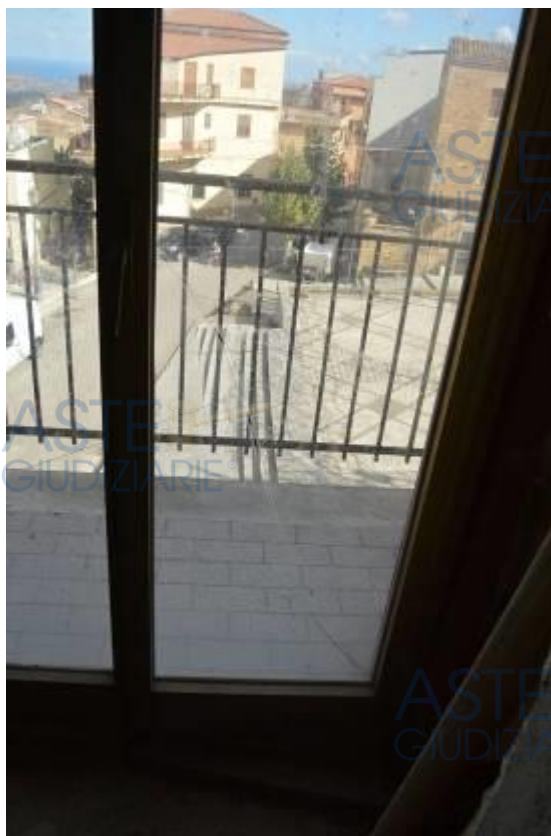
Infissi con vetro rotto
