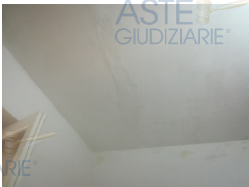
Infiltrazioni dal terrazzo
