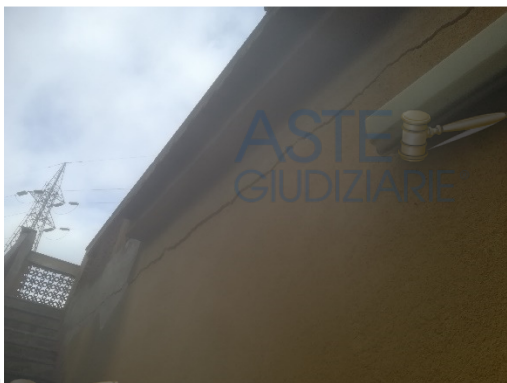
Lesioni prospetto lato Ovest
