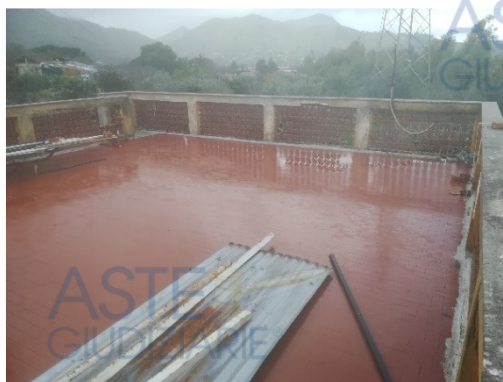
Parapetto terrazza pericolante
