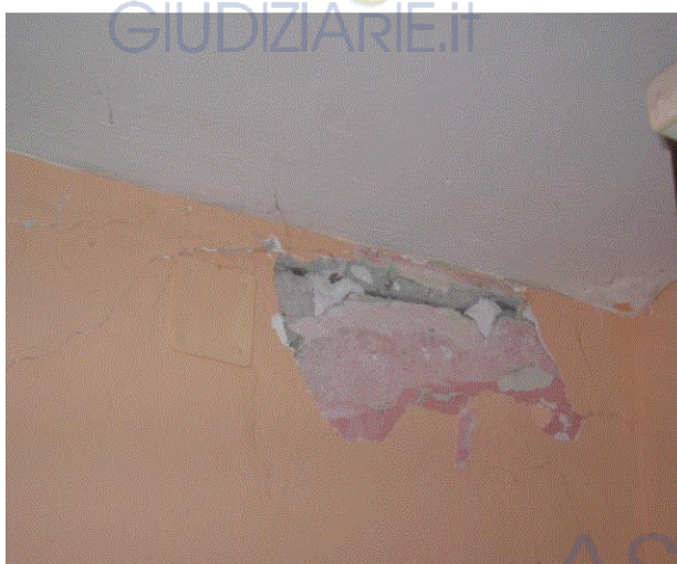
Dettaglio ammaloramento murature
