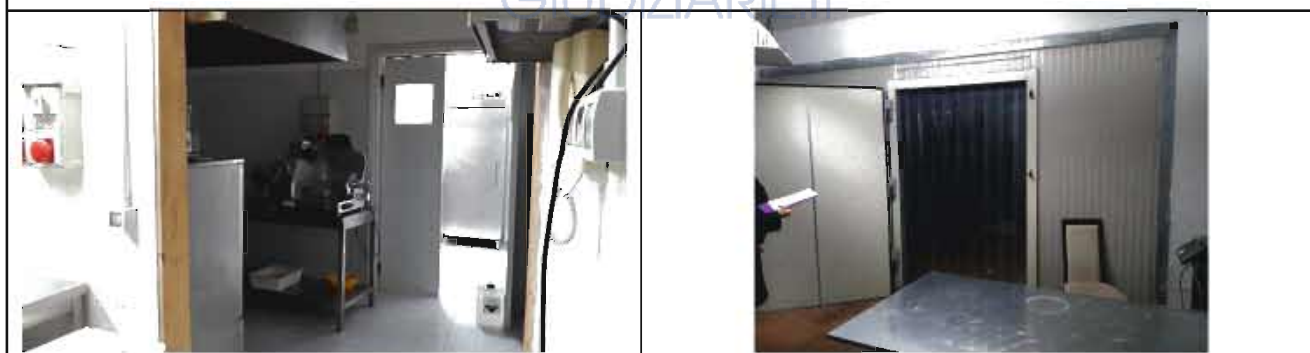
Foto 7-8 | Locali cucina industriale e ingresso cella frigorifera
