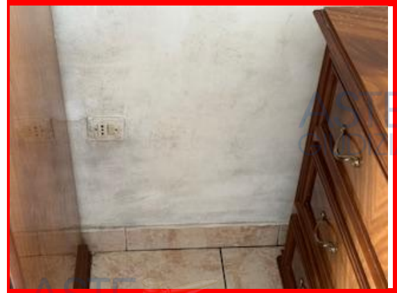
Foto 16 - Zona di muffa pareti verticali.
