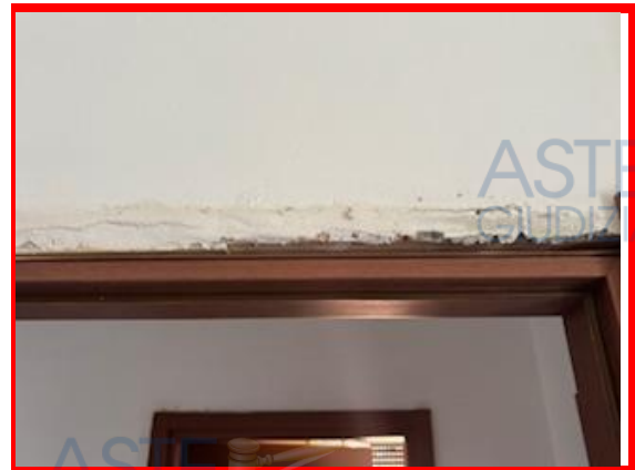
Foto 18 - Zona di intonaco deteriorato.
