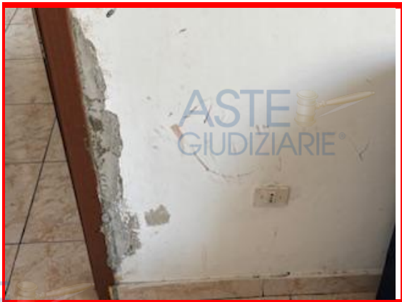
Foto 17 - Zona di distacco intonaco.
