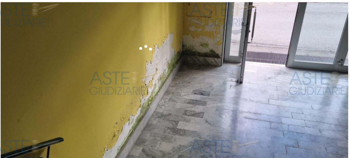
Presenza di muffa parete androne fabbricato
