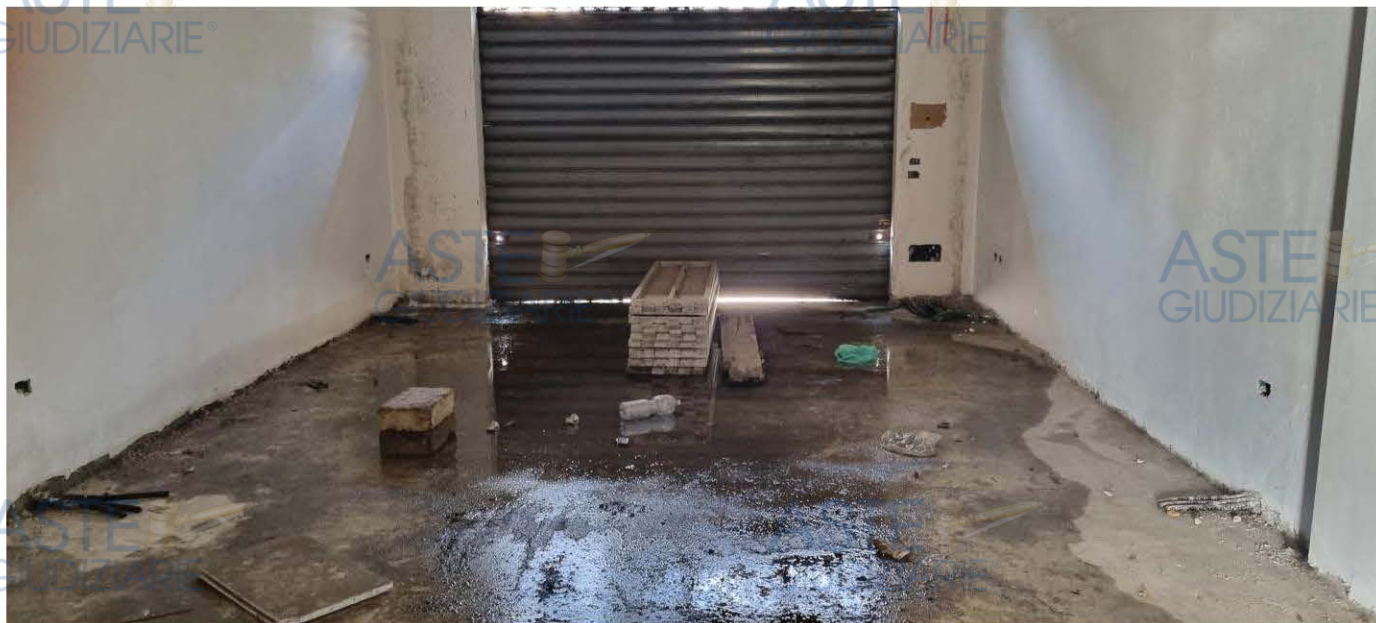
Punto di ristagno dell'acqua
