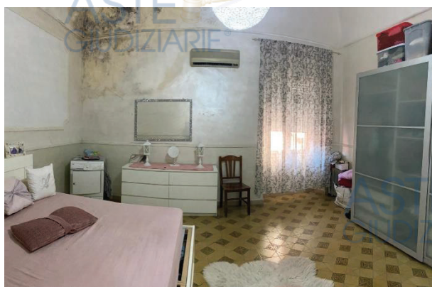
Figura 19- Infiltrazioni solaio soggiorno-cucina
