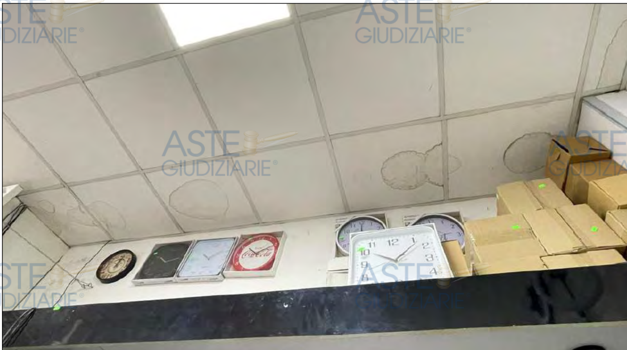
Controsoffitto: presenza di aloni scuri
