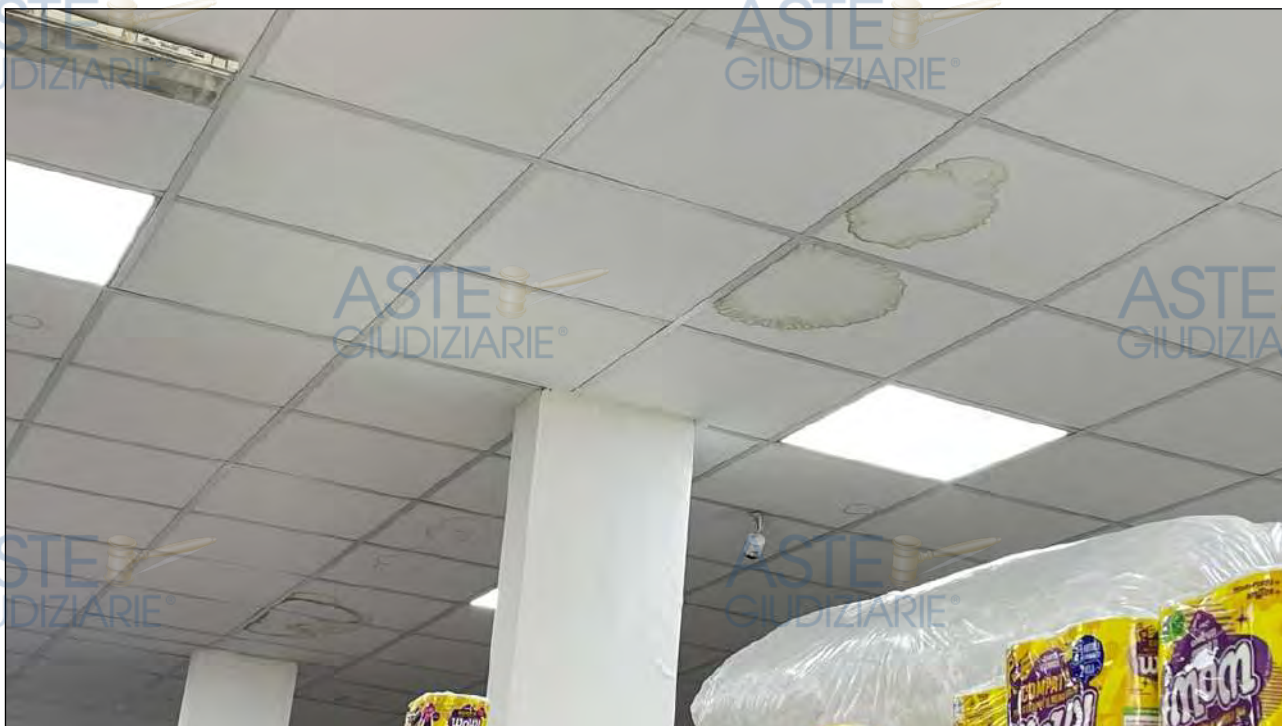
Controsoffitto: presenza di aloni scuri
