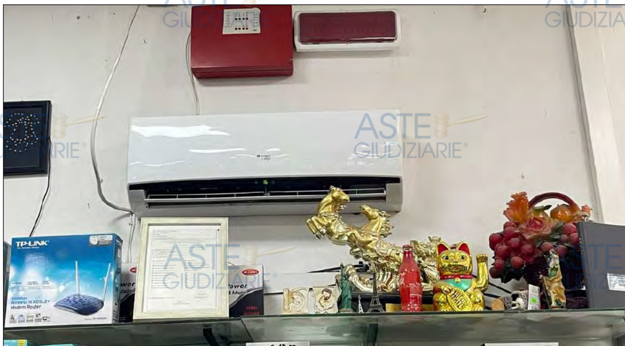
Split aria condizionata
