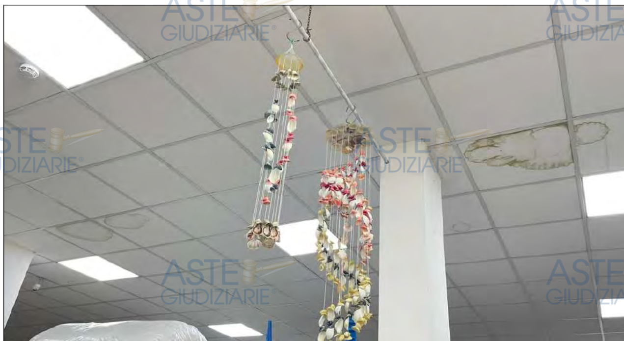
Controsoffitto: presenza di aloni scuri
