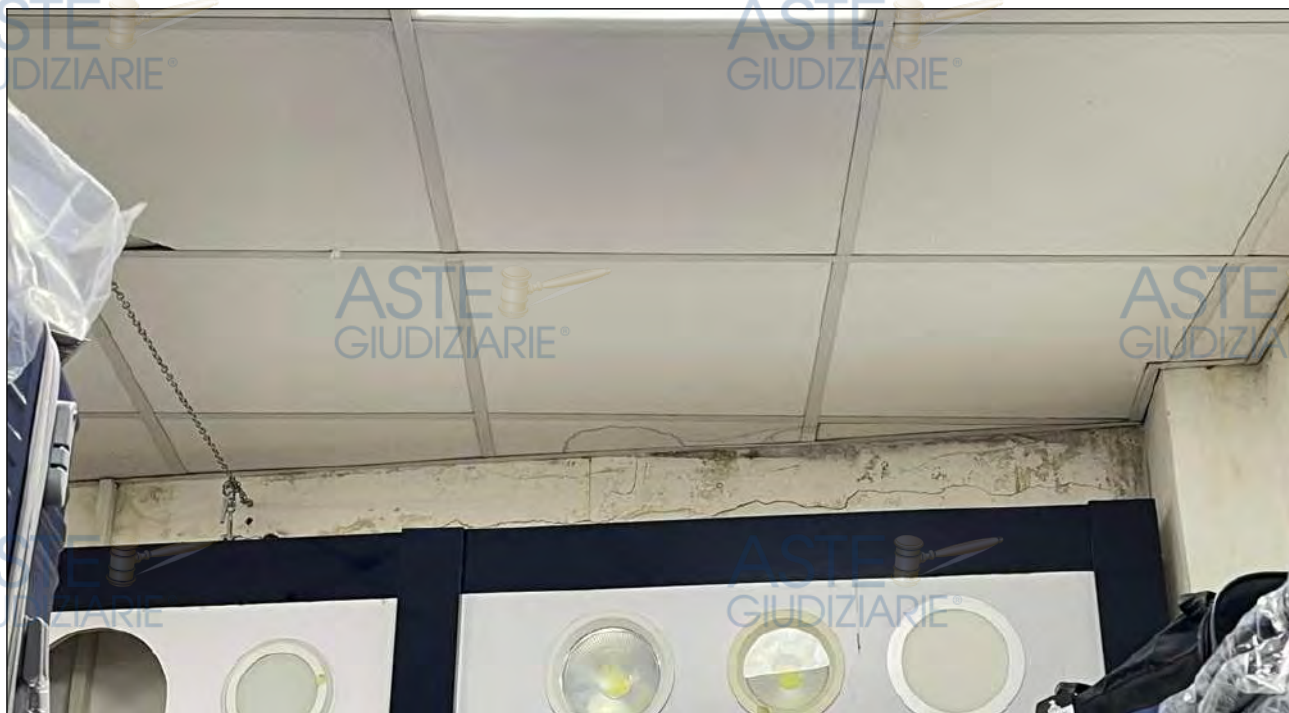
Parete sud: presenza di lesioni superficiali di intonaco, aloni scuri e sfogliamenti di pittura
