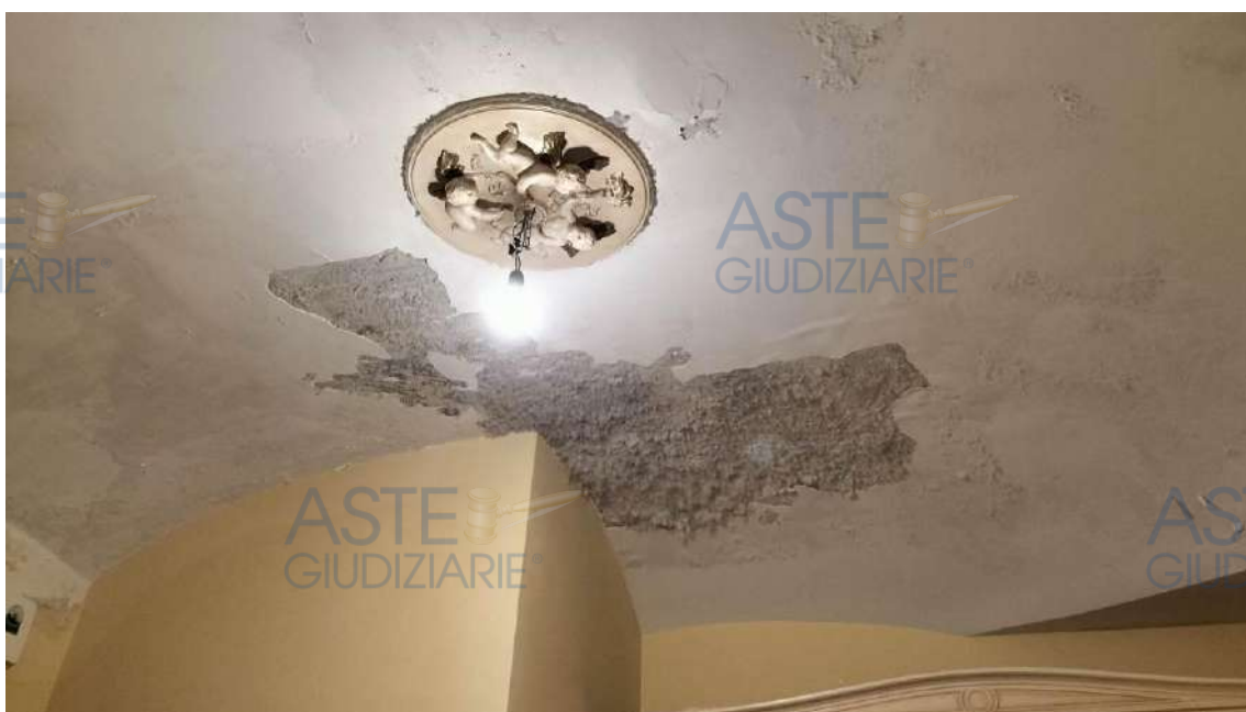
Particolare soffitto Camera 1
