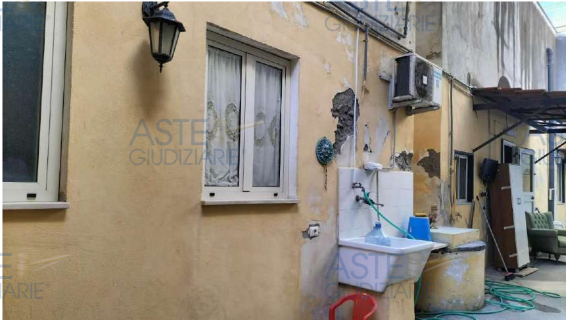
Androne comune scoperto_ stato manutentivo prospetto p.t.
