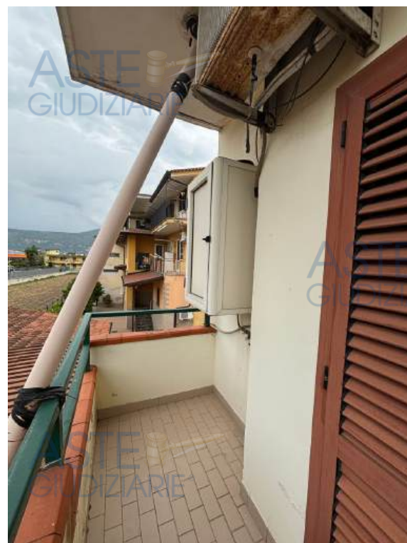
Vista area esterna - caldaia
