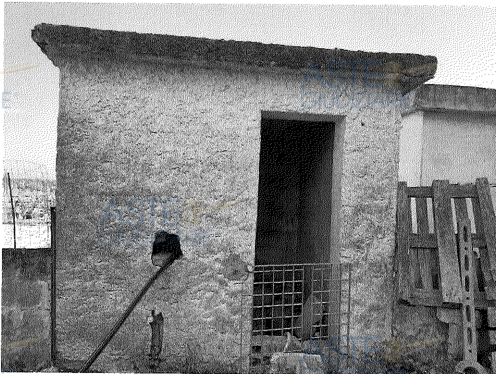
Foto 10: locale pozzo artesiano
