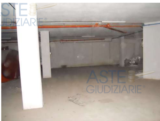
FOTO – deposito con canalizzazioni di scarico
