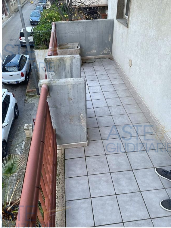
Foto 13 – Balcone su via Brindisi
