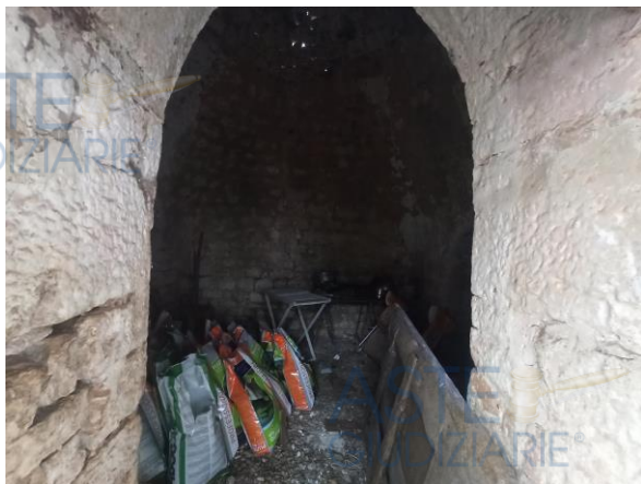
Foto n.9 – Sezione pericolante e Terrazzino retrostante fabbricato
