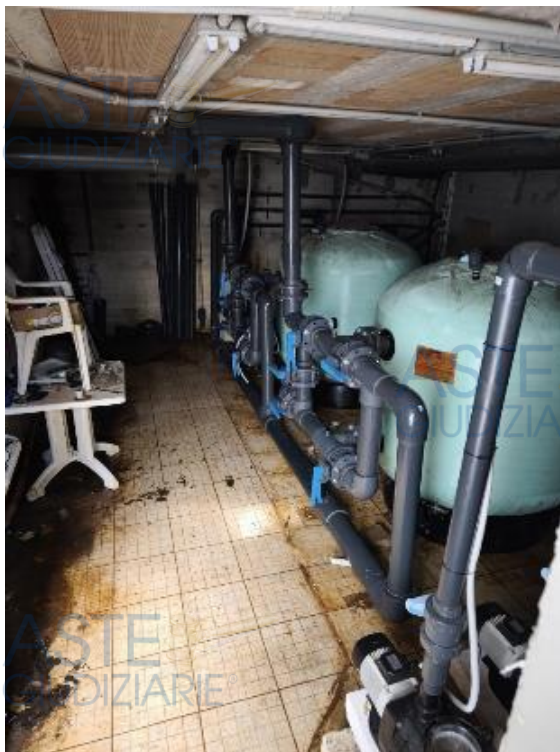
Fig. 32) Locali tecnici per l'impianto della piscina
