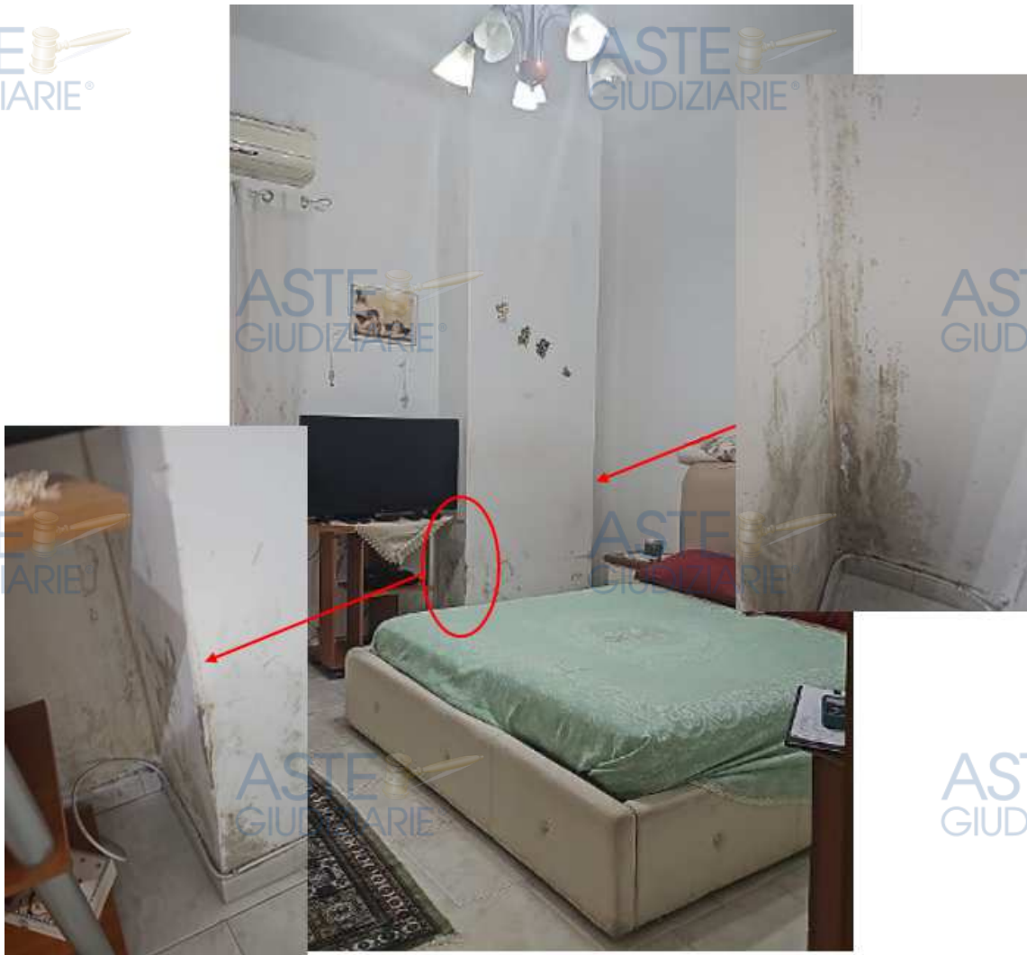
Foto 5 – Stato conservativo camera matrimoniale
