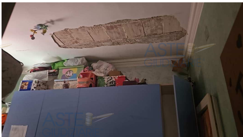
Foto 11 – Distacco strato pittura ed intonaco
