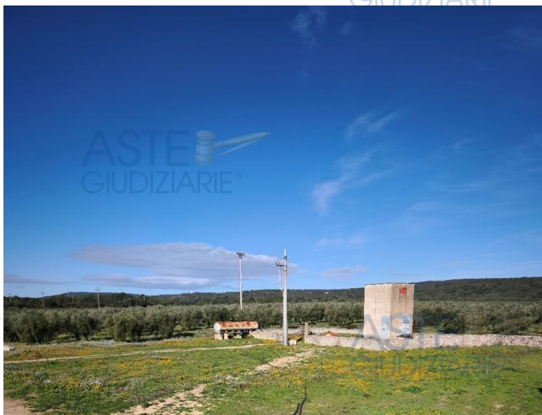
Fig. 35) Cabina elettrica non utilizzata
