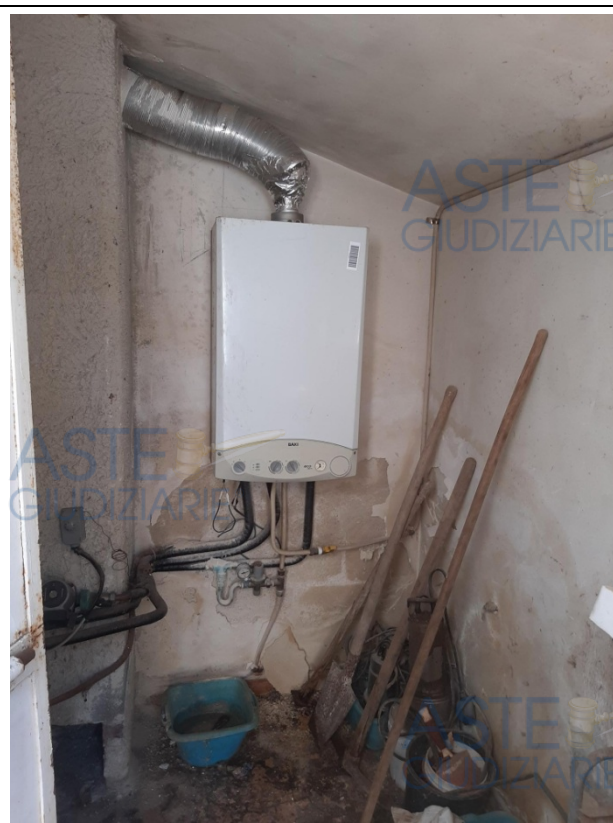
10. Piano rialzato - Vano caldaia
