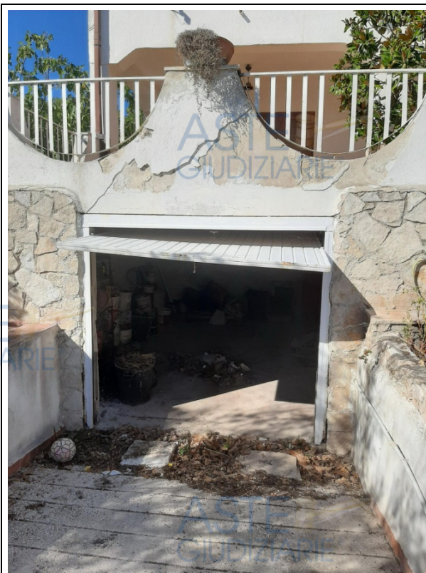
5. Ingresso box auto con intonaco esterno degradato
