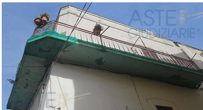
Foto 1 – Stato conservativo balcone
