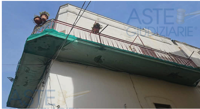
Foto 1 – Stato conservativo balcone
