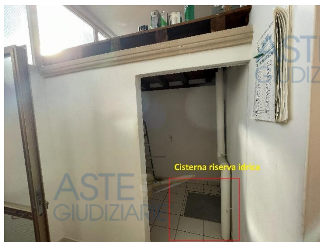
Ripostiglio (ricavato mediante la realizzazione di un tramezzo in tufo da 10 cm)
