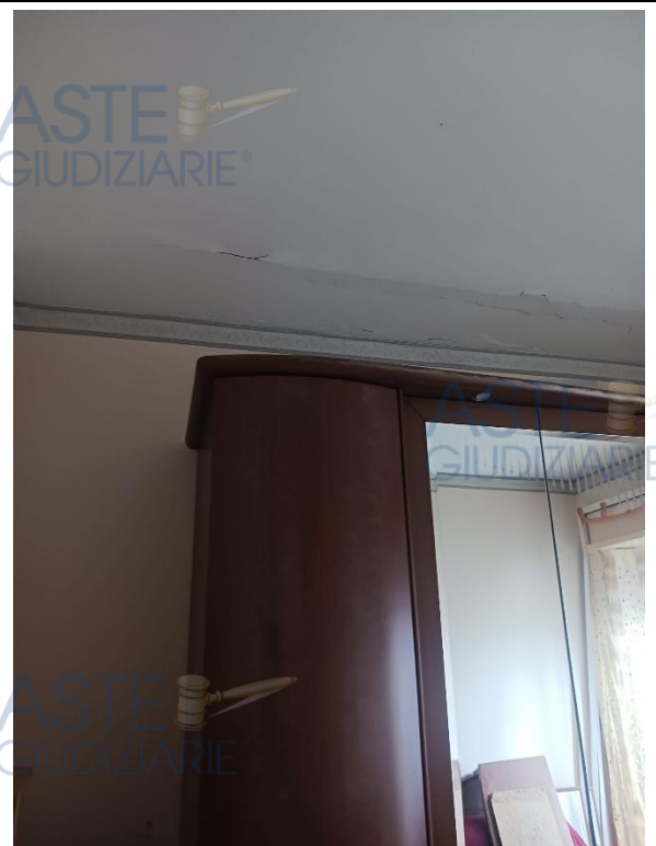
12. Dettaglio dell'intradosso del solaio con distacco d'intonaco
