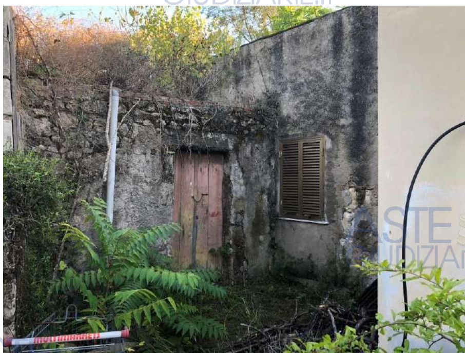
Immagine 21. Ulteriore immagine di uno degli edifici fatiscenti presenti nel lotto
