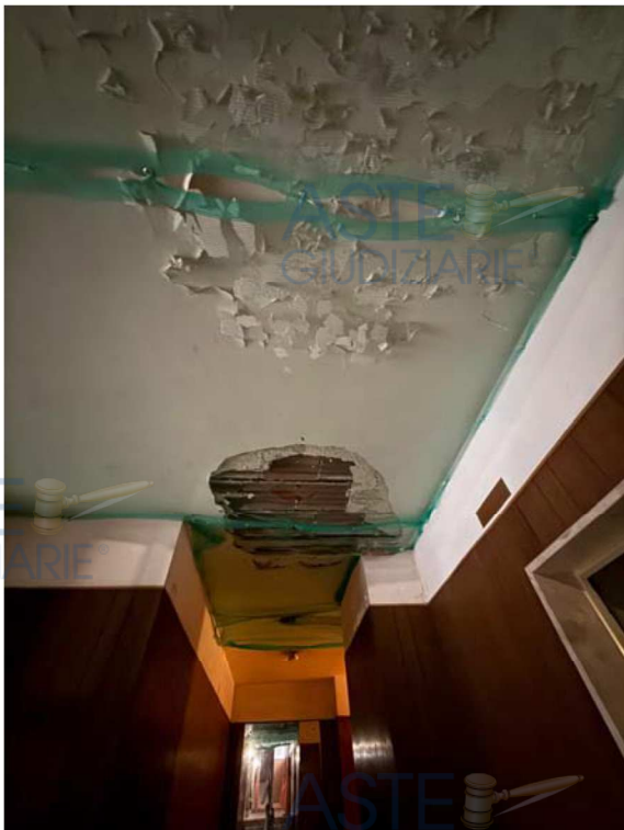
Danni sulle parti interne dell'androne condominiale
