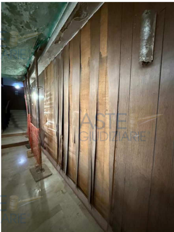
Danni sulle parti interne dell'androne condominiale
