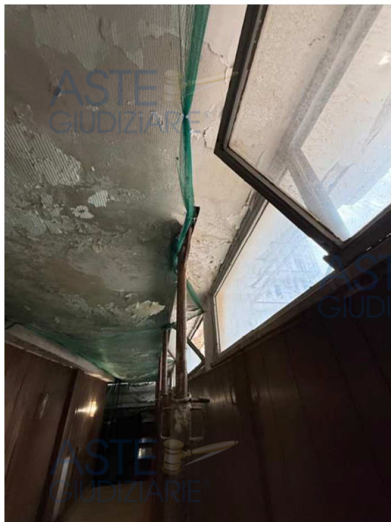
Danni sulle parti interne dell'androne condominiale
