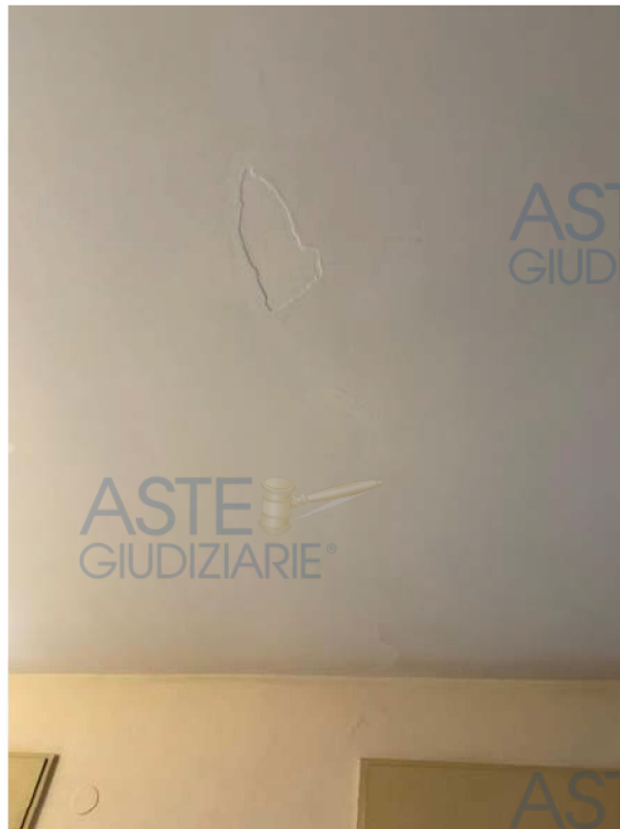
Danni sul soffitto corrispondente alla parete esterna
