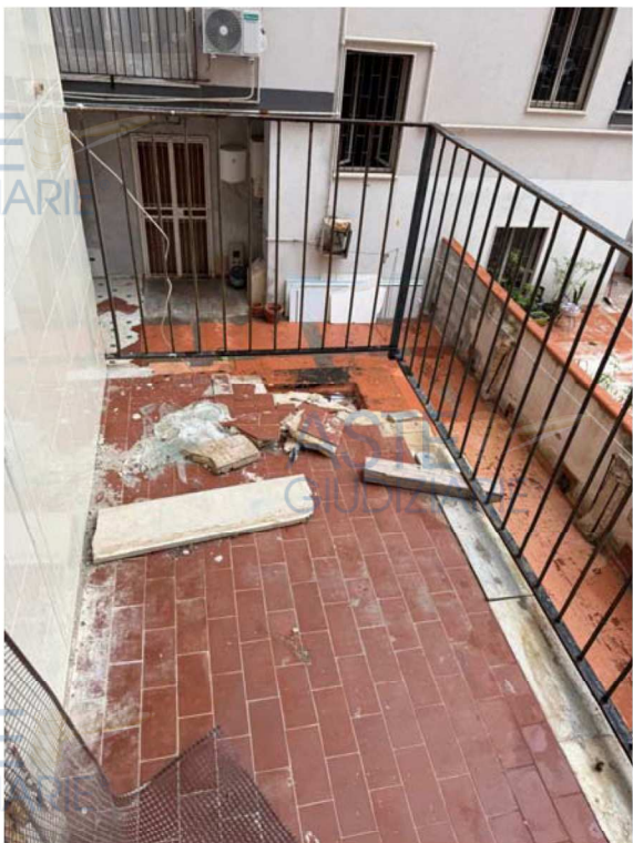
Porzioni di balcone crollate
