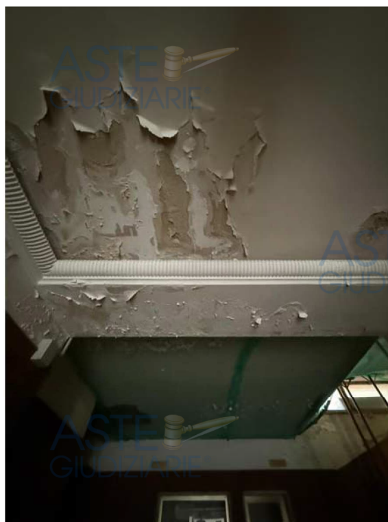
Danni sulle parti interne dell'androne condominiale
