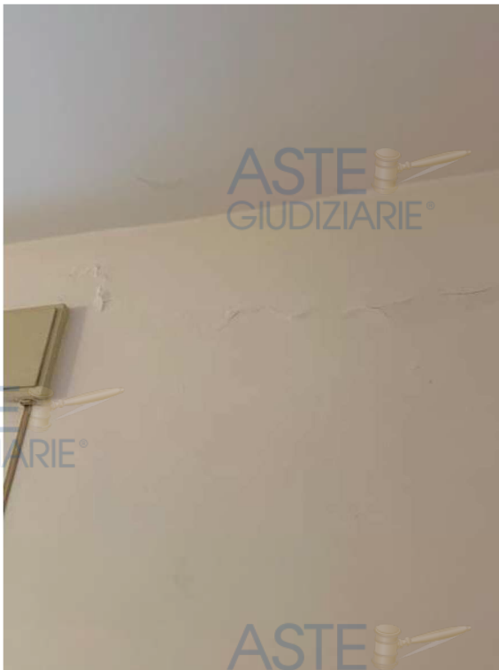
Lesioni sulla parete interna confinante con l'esterno
