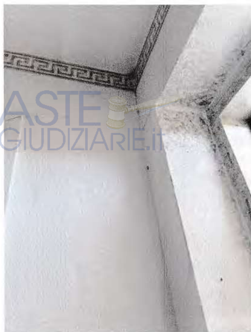
Foto 22: umidità vano scala
