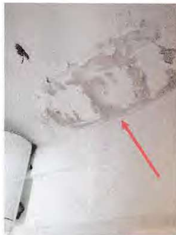
Foto 10: umidità soffitto vano WC
