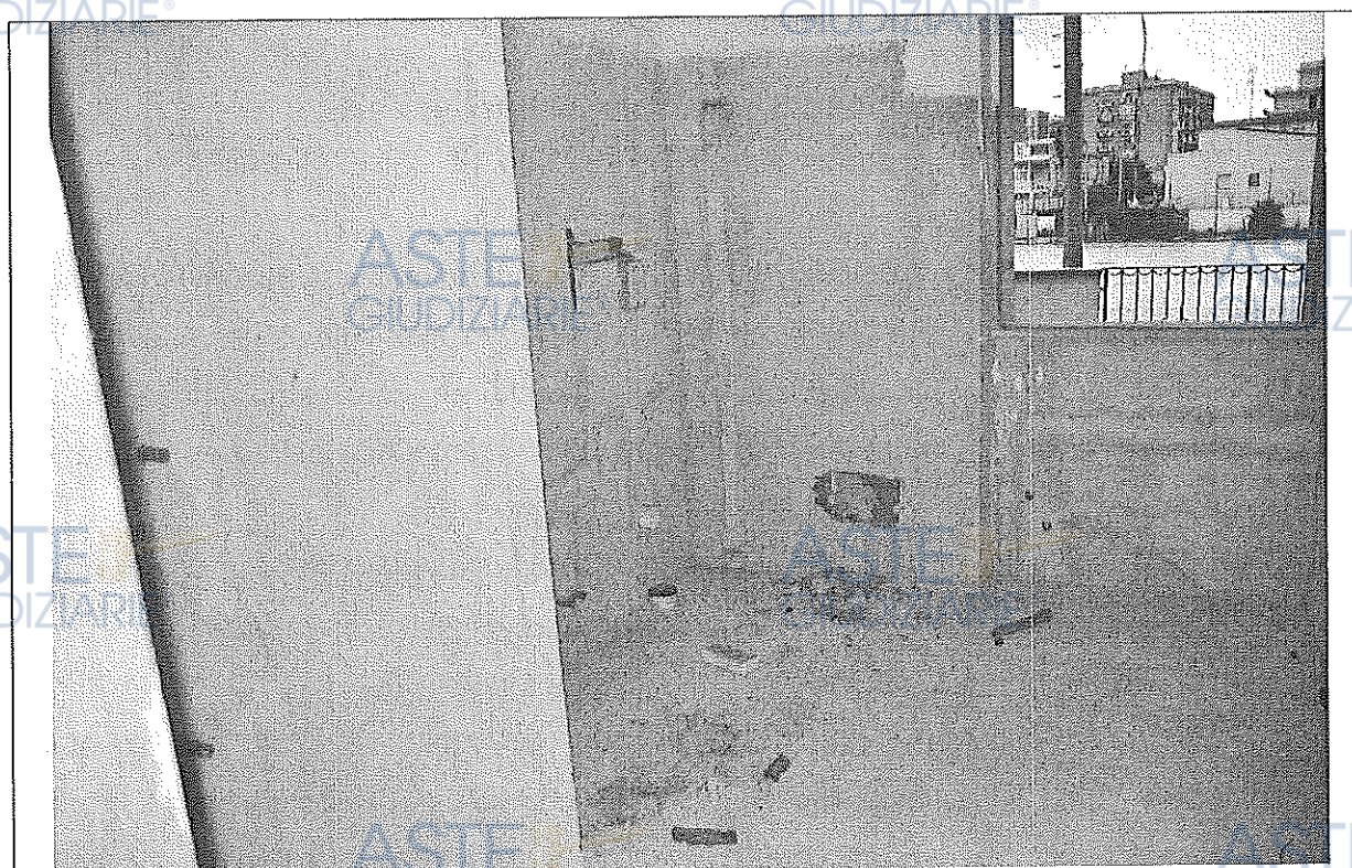
Foto n. 37 – Servizio igienico privo di sanitari
