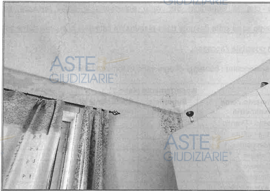
17 - Lesione e infiltrazioni d'acqua soffitto camera 2
