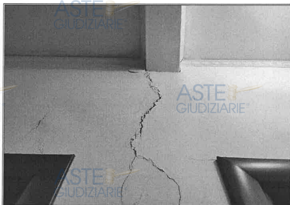
12 - Particolare lesione disimpegno
