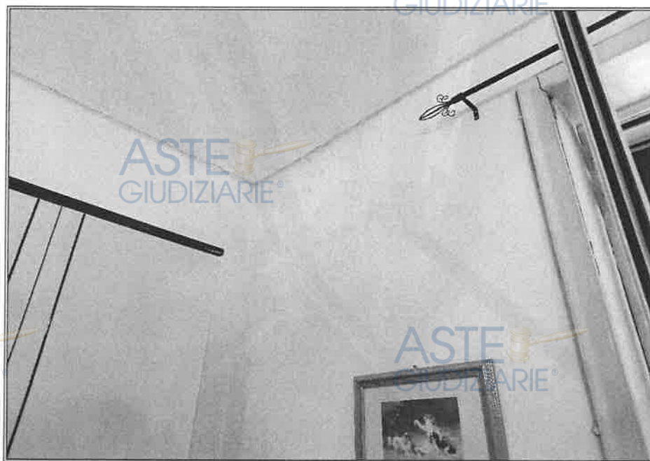
13 - Infiltrazioni d'acqua camera 1
