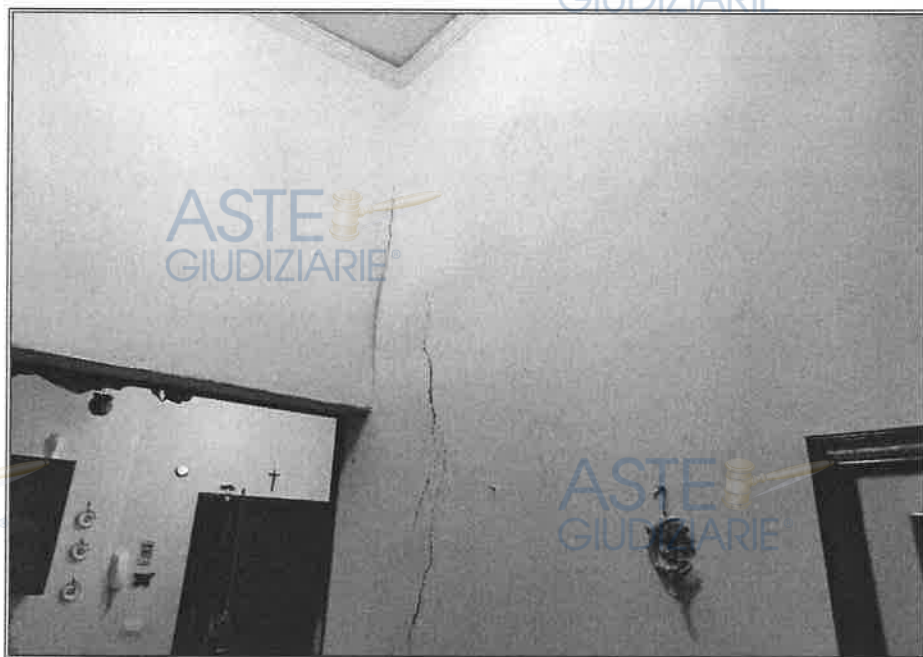
11 - Particolare lesione interna in corrispondenza del disimpegno
