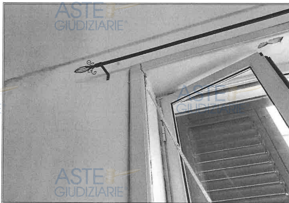
14 - Lesione porta finestra e infiltrazione d'acqua camera 1
