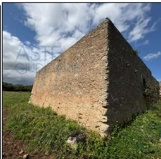
Foto_24 Particolare degrado
