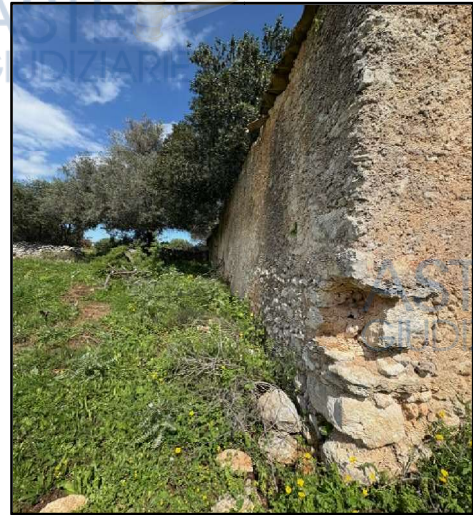
Foto_26 Particolare degrado
