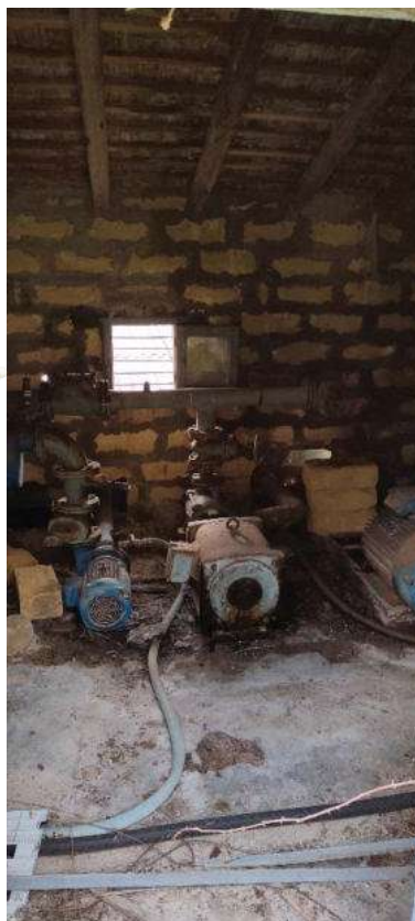
Foto 66 locale tecnico plla 237
