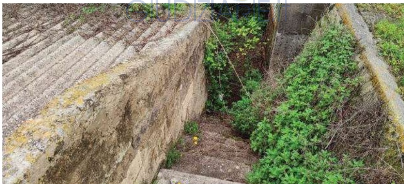
Foto 72 locale vasca plla 237
