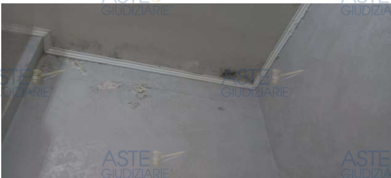
Foto 21 – Immobilità “1A” – Umidità al P.T.
