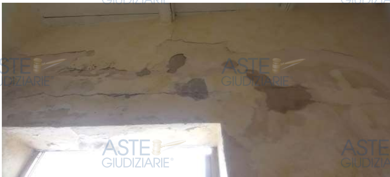
Foto 19 – Immobile “1A” – Umidità al I P
