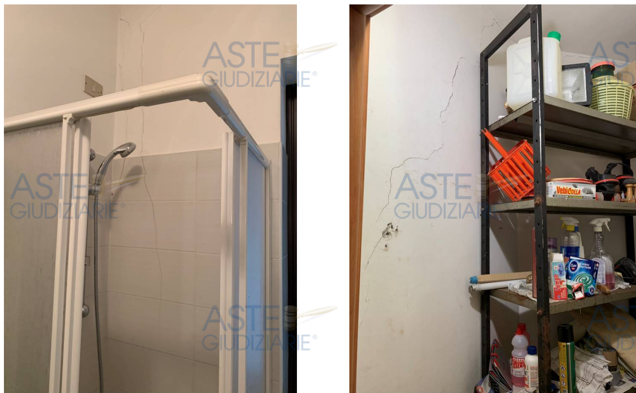
Figura 12: lesioni box doccia e parete ripostiglio/ingresso
