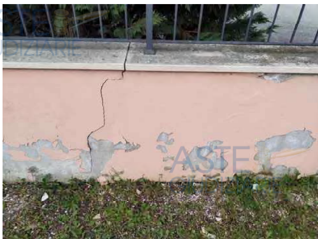
Particolare del degrado del muretto di recinzione
