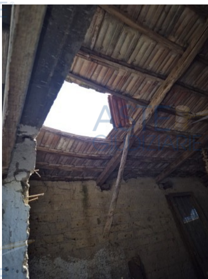
Figura 32 condizioni del tetto del box auto pertinenziale
