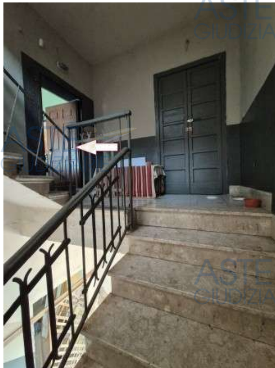
Figura 9 vano scala comune privo di ascensore
