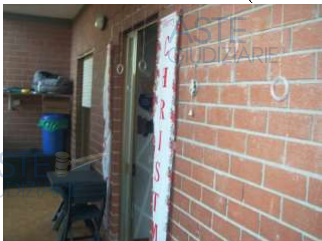
(foto 2: Vista ingresso e balcone pertinenziale)
