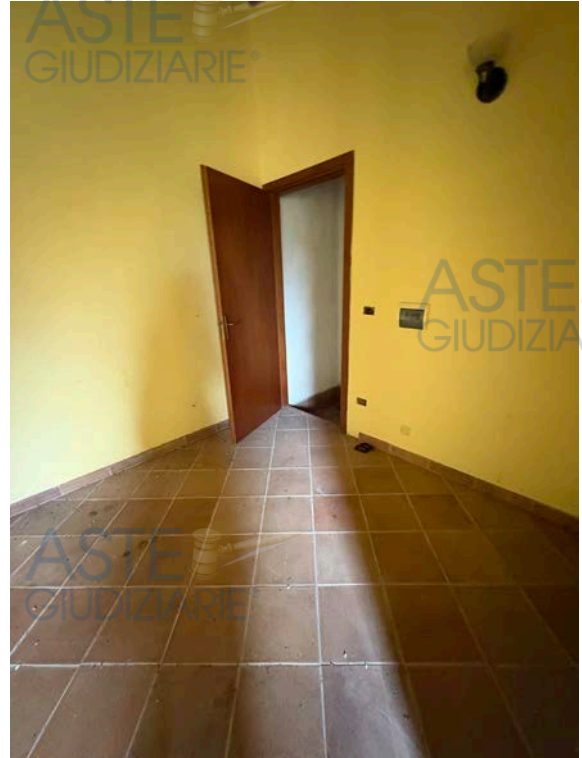
Fotografia n. 10 _ Vano p.lla 5237 sub 1 al piano primo; porta di collegamento alla scala interna
