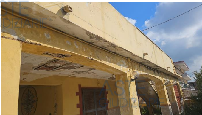
Porticato al P.T - sfondellamento del solaio
