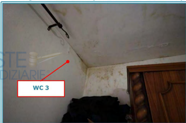
Figura 37 Ammaloramenti presenti nella Camera 3
