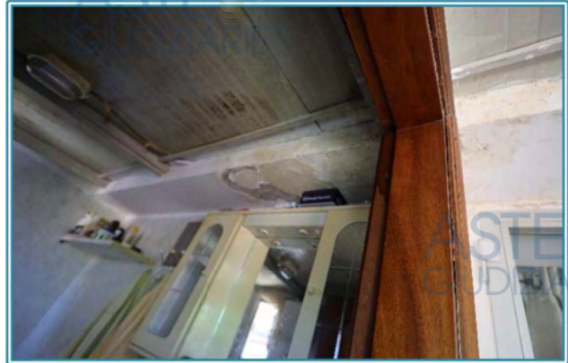
Figura 34 Infiltrazione presente nel WC 4
