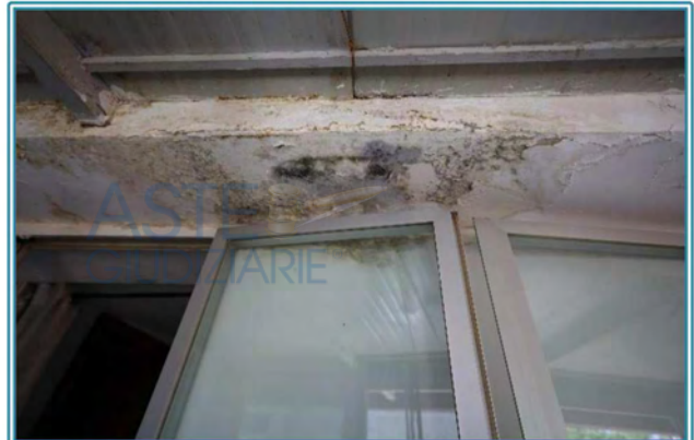
Figura 30 Infiltrazione (Piano Secondo - Sottotetto)
