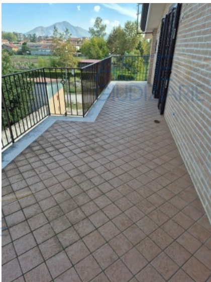
Figura 30 balcone 1 primo piano
