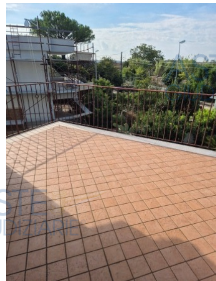
Figura 31 balcone 2 primo piano
