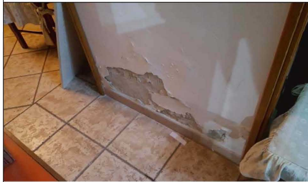
Distaccamento intonaco dalle pareti
