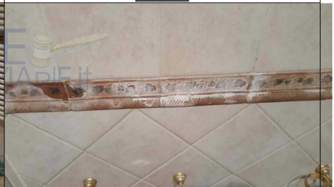
Umidità dalle piastrelle del w.c.
