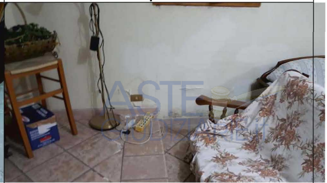
Distaccamento tinteggiatura dalle pareti
