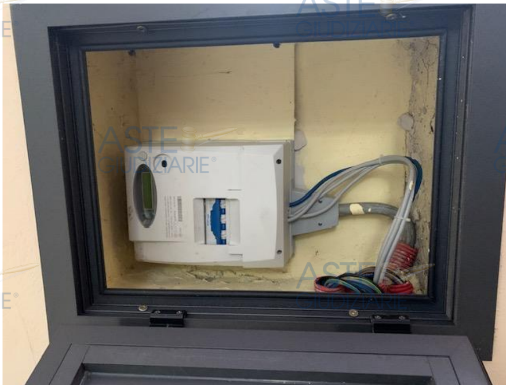
Vista interna sub 36
