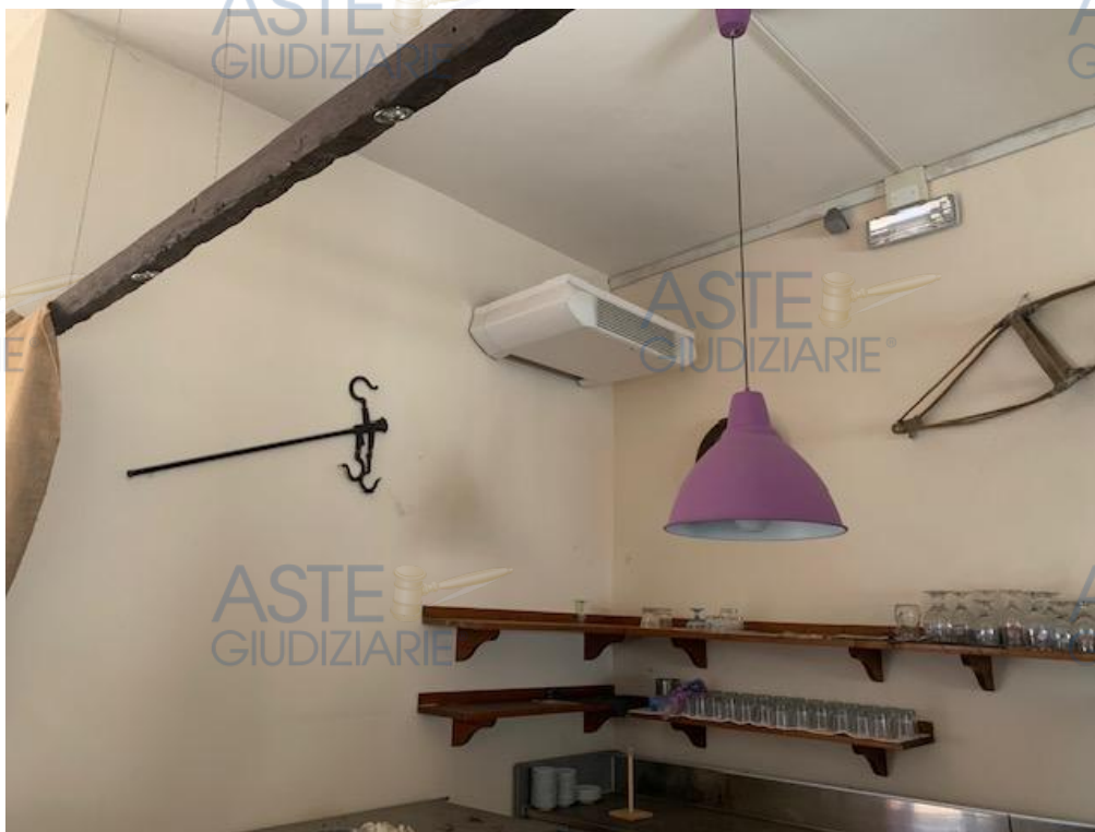
Vista interna sub 36
