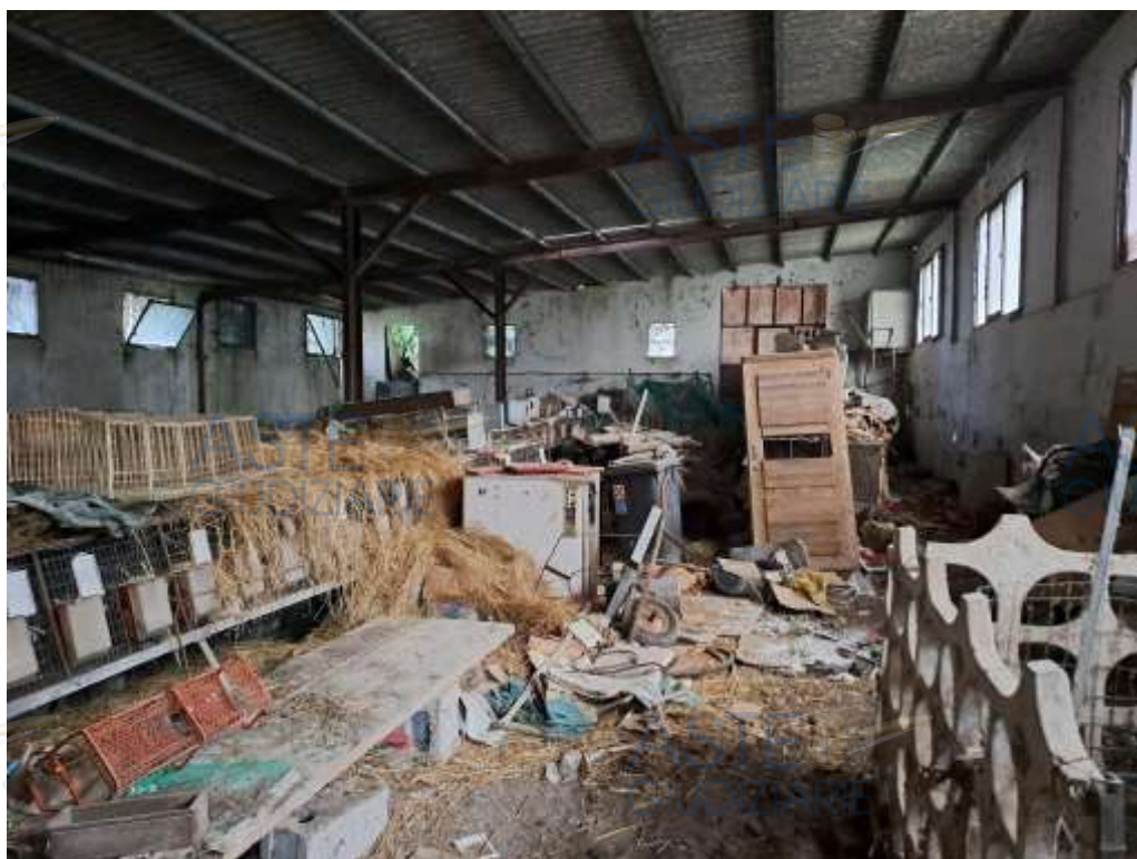
Fig. 29_ Foto interna manufatto_Corpo 5
