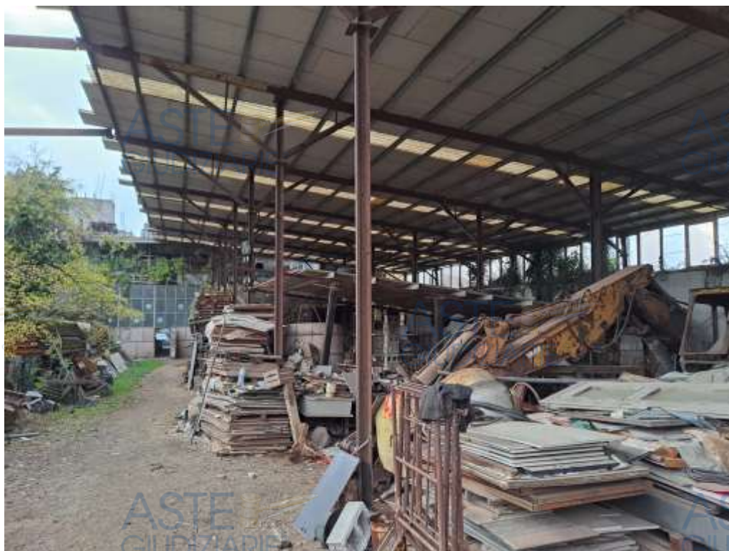
Fig. 28_ Foto interna manufatto_Corpo 2
